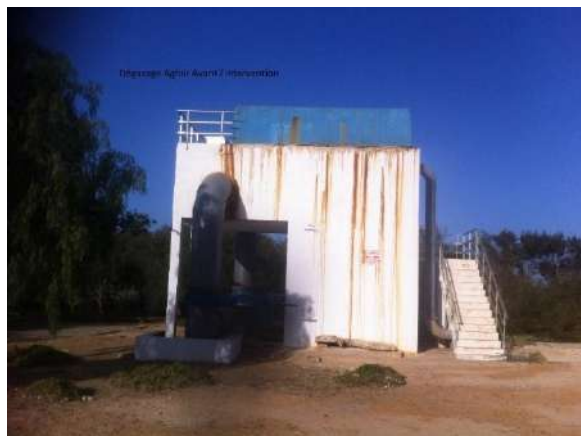
Ouvrage de dégazage
