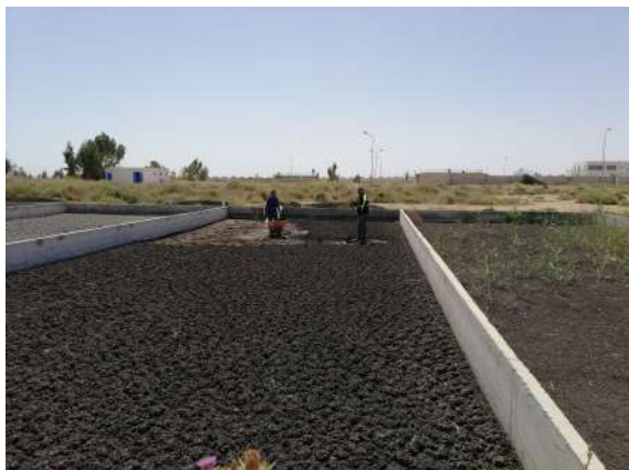
Lits de séchage des boues
