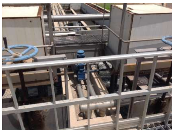
Surpresseur pour air-lift extraction des sables
