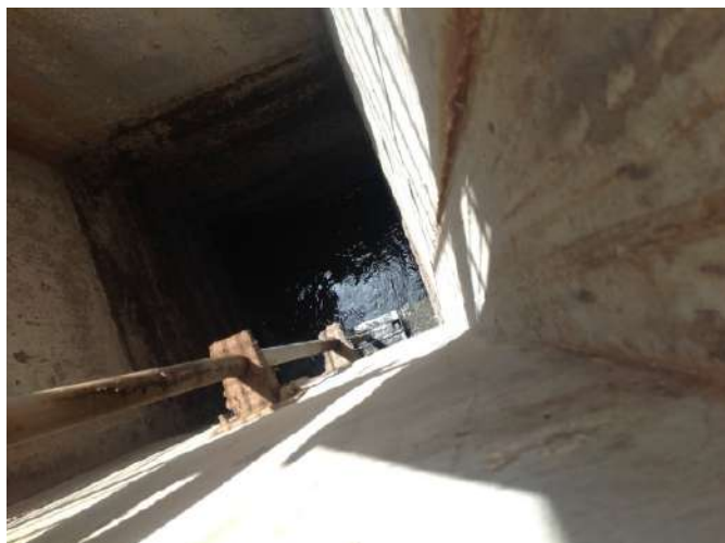
Bâche d'arrivée des eaux brutes
