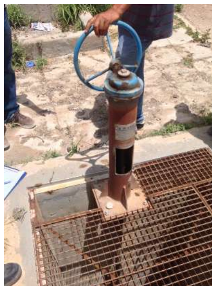
Vanne de by-pass général de la station
