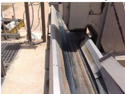
Bande transporteuse de déchet
