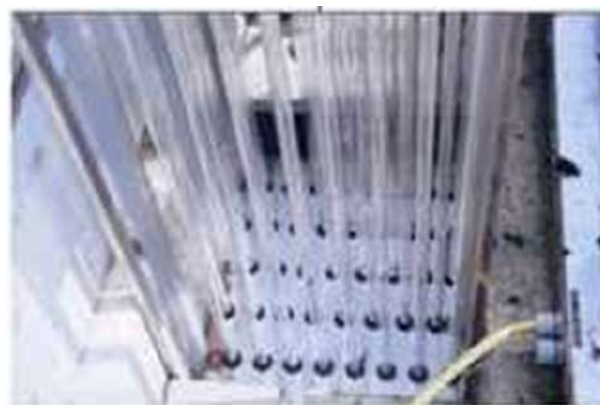
Figure 12 : Exemple de module de lampes verticales
