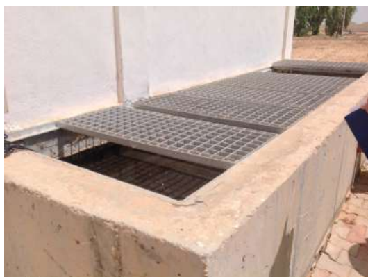
Bâche à boues
