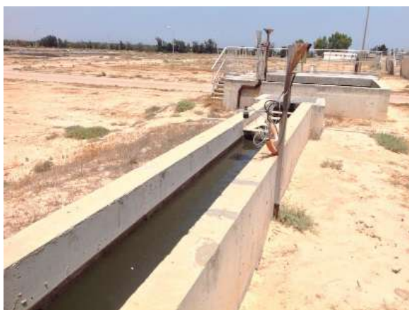
Canal de comptage des eaux prétraitées
