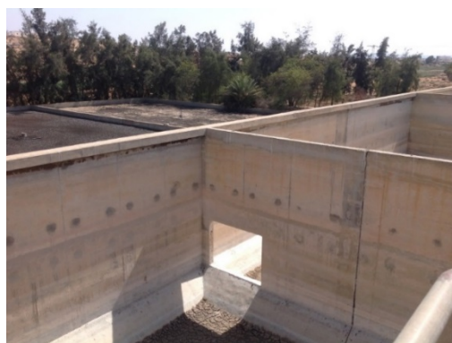
Vue partielle bassin d'aération bassin post-nitrification
