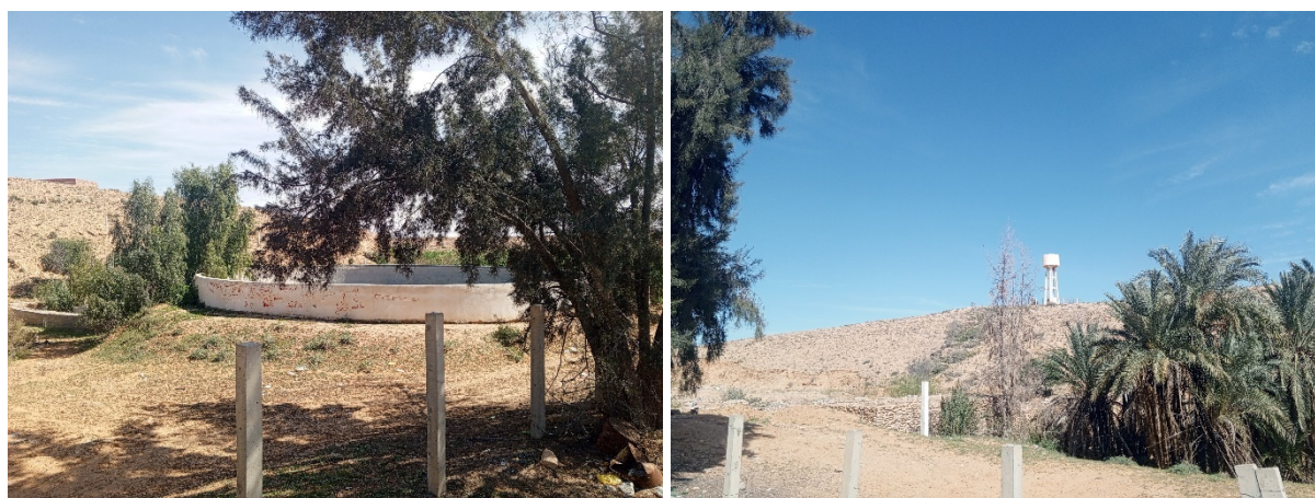
Figure 10 : Station de pompage réalisée par le CRDA pour la réutilisation des EUT en irrigation
