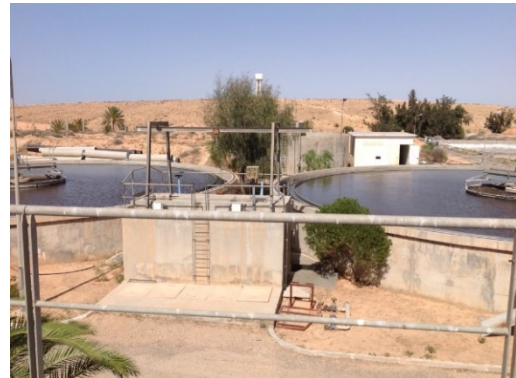
Vue partielle des deux clarificateurs
