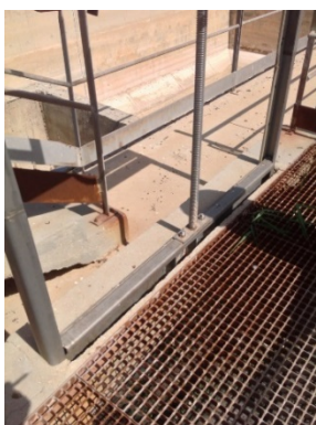
Vanne isolement du bassin biologique
