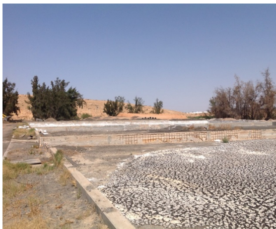
Vue partielle lit de séchage
