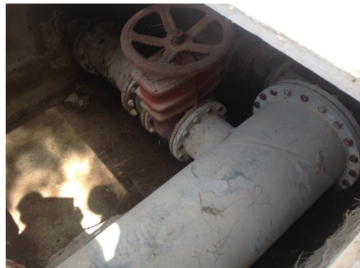
Chambre à vannes et clapets
