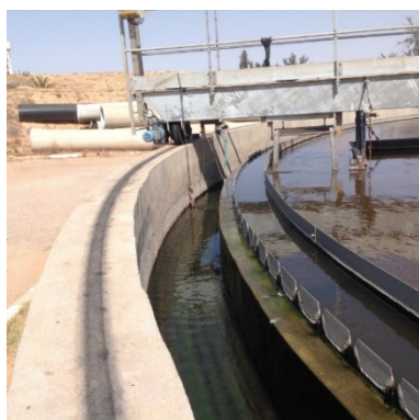
Bande roulante d'un clarificateur
