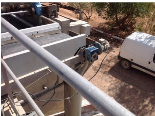
Bande transporteuse de déchets
