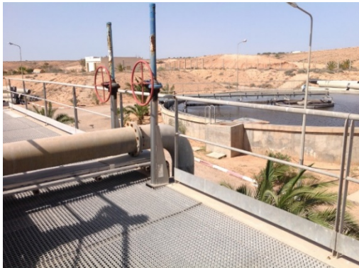
Vannes d'isolement des clarificateurs
