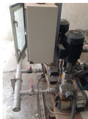
Pompes de lavage
