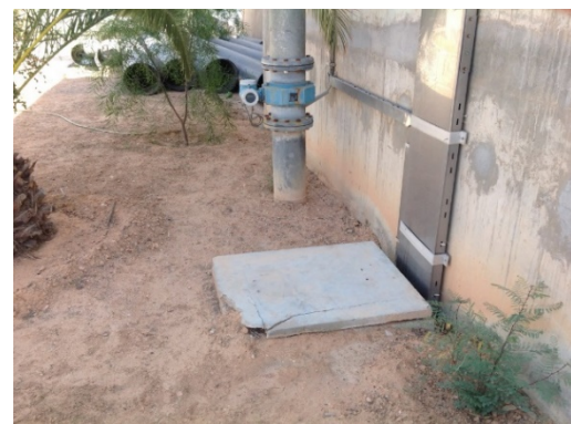
Débitmètre boues recirculées
