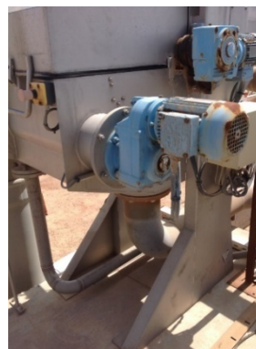
Vue partielle du Prepazur
