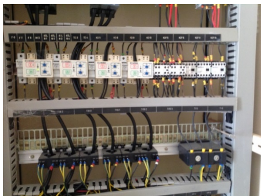
Intérieur armoire électrique
