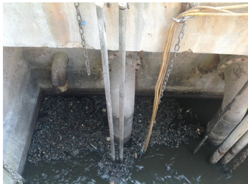
Intérieur bache de relevage
