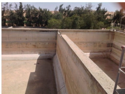
Vue partielle zone anoxie et bassin aération
