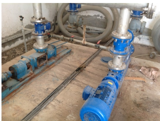
Pompes à boues épaissies
