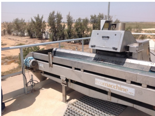
Bande transporteuse de déchet
