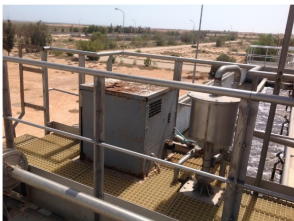
Surpresseur pour air-lift extraction des sables
