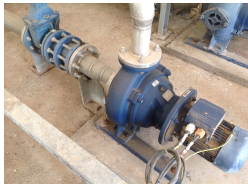
Pompe de recirculation
