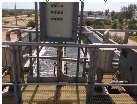
Vue partielle dessableur-dégraisseur
