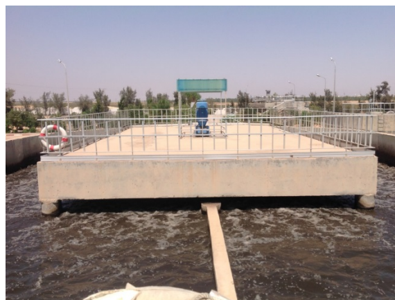
Plateforme avec turbine lente d'aération
