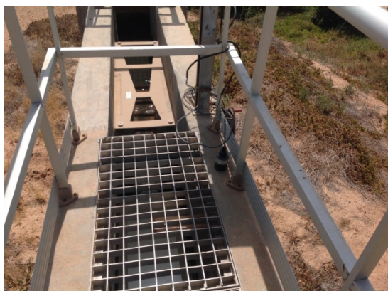
Canal de comptage des eaux prétraitées
