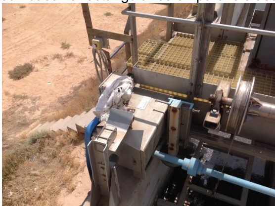
Motoréducteur en réparation
