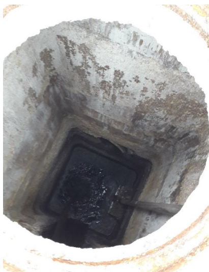
Regard d'arrivée avec vanne à droite et trop plein en haut
