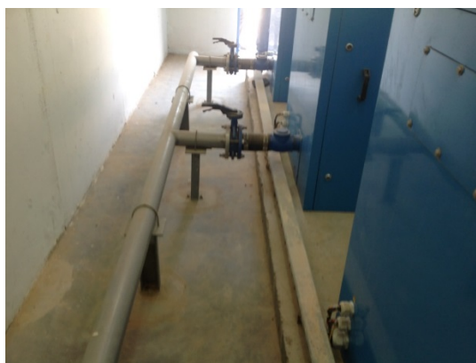
Vue partielle des surpresseurs dégraisseurs
