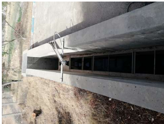
Canal venturi de mesure de débit des eaux épurées
