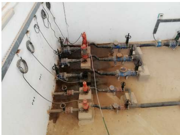
Station des boues
