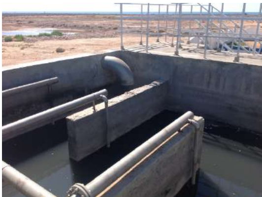
Vue partielle de la bache de dégazage
