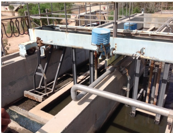
Vue générale dessablage-dégraissage
