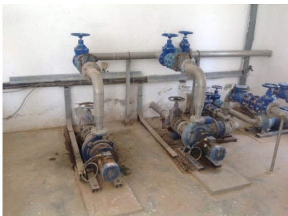
Pompes boues en excès
