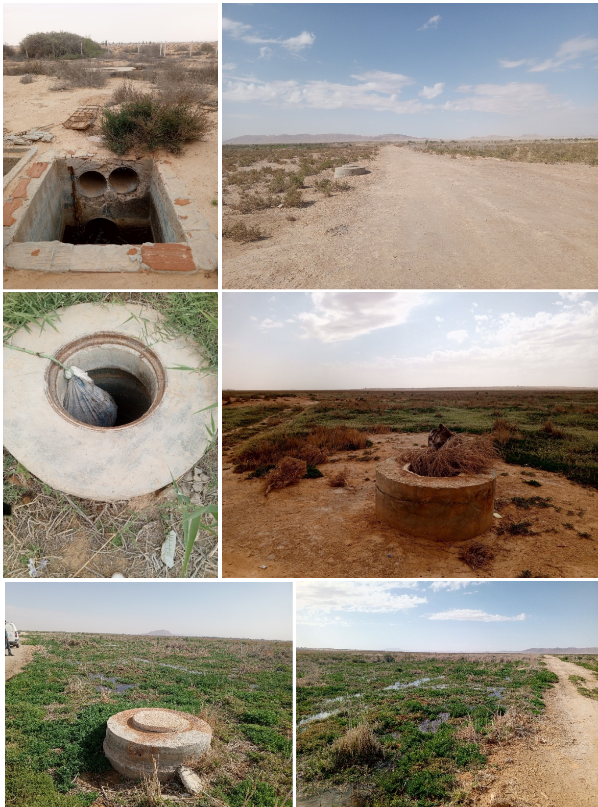
Figure 8 : Conduite de rejet des EUT et débordement des regards (Avril 2024)
