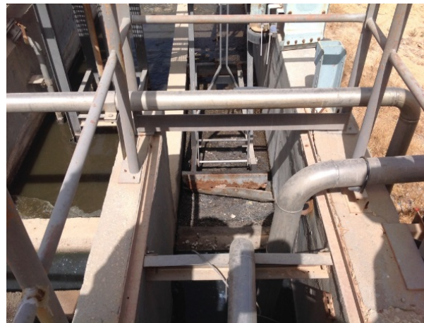
Vue générale dessablage-dégraissage
