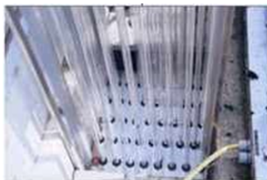
Figure 14 : Exemple de module de lampes verticales
