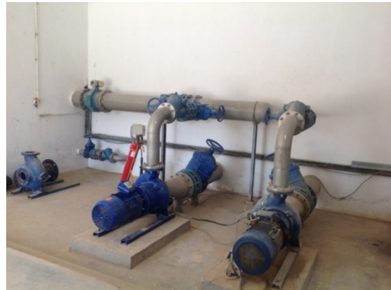
Pompe neuve de recirculation
