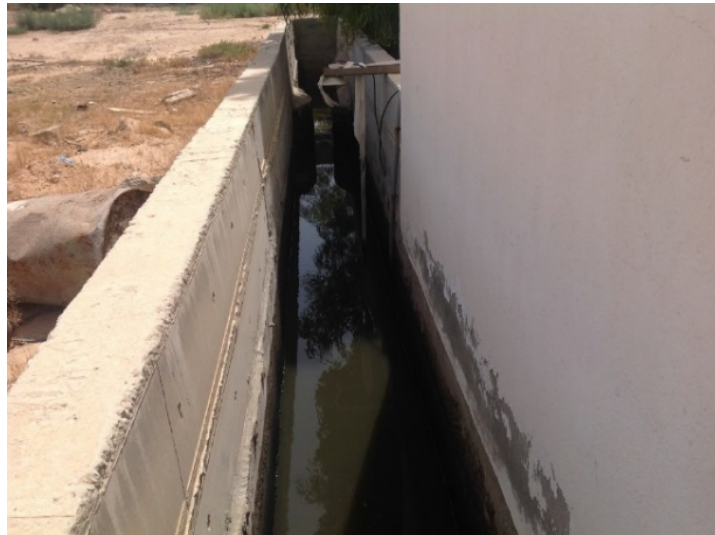
Canal de rejet
