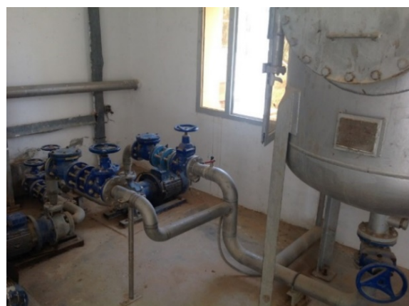
Pompes eaux de lavage
