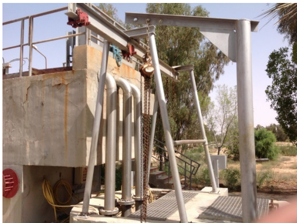
Poste de relevage
