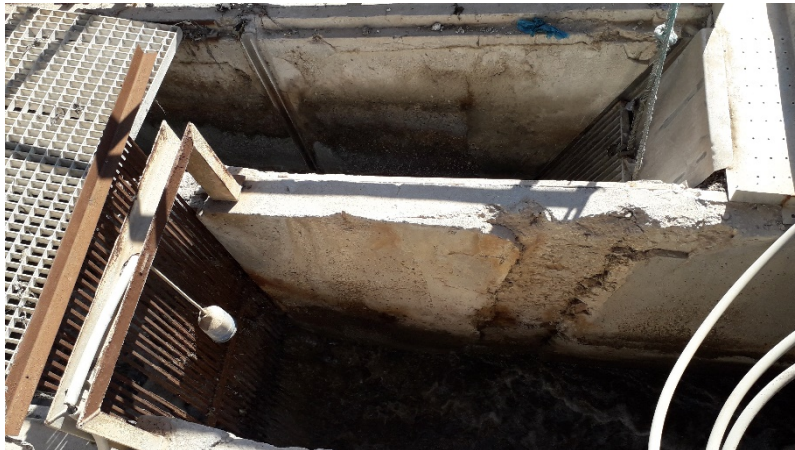
Dégrilleur fin à gradins automatique
