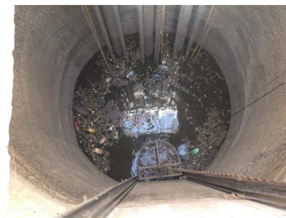
Vue intérieure du poste
