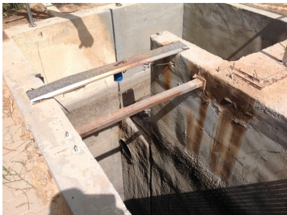
Vue partielle du poste de relevage
