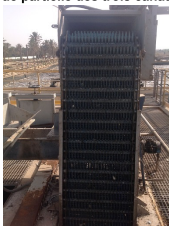
Etat ancien dégrilleur en place
