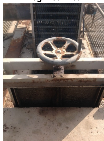
Etat vanne isolement dégrilleur
