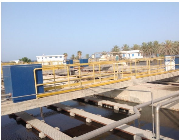
Vue partielle des surpresseurs Aerzen
