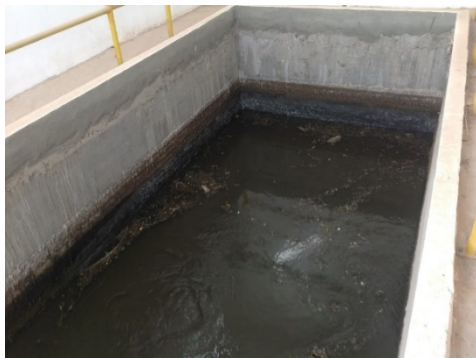
Fosse à bâtard
