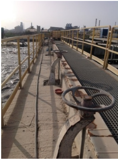
Vannes d'isolement des décanteurs lamellaires
