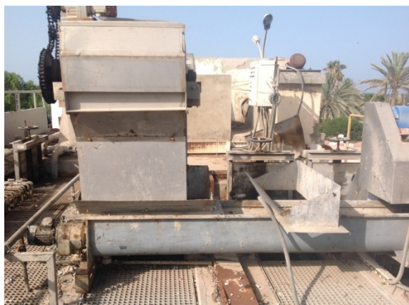
Vue partielle des trois canaux
