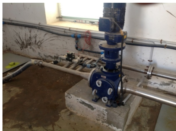
Dilacérateur à boues avant centrifugeuse
