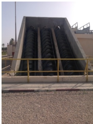
Vue partielle des vis d'Archimède
