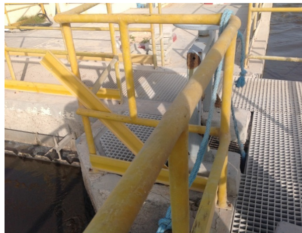
Vue partielle canal de recirculation
