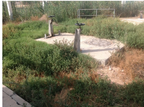
Vanne de by-pass fosse à bâtard
