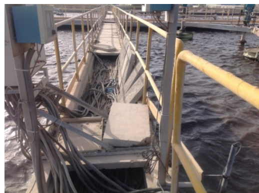
Sonde d'oxygène et état du chemin de câblage
