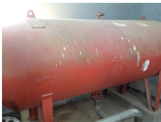
Ballon de pressurisation
