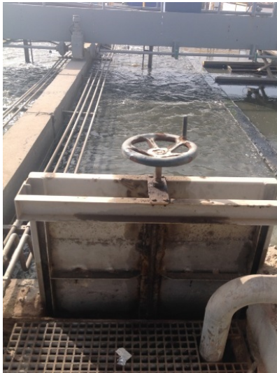
Vanne isolement canal dessablage-dégraissage
