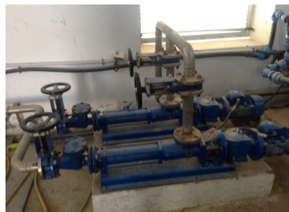
Pompe injection polymère vers centrifugeuse
