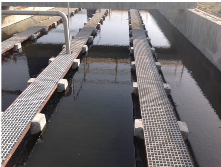
Voile de boues visible au-dessus du décanteur
