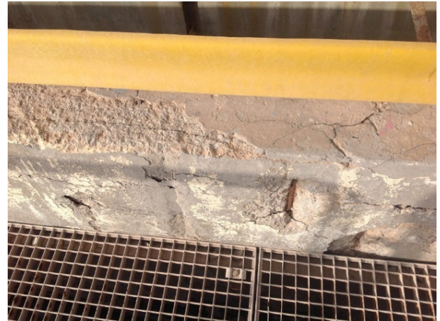
Génie civil dégradé
