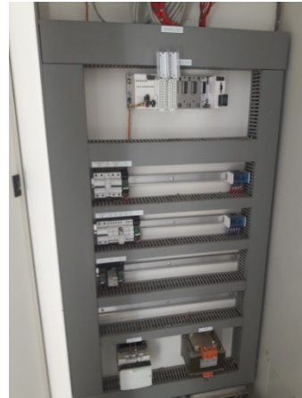
Intérieure armoire électrique
