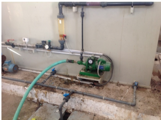
Pompes à émulsion vers préparation polymère
