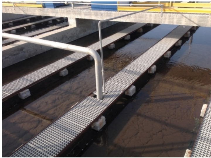
Vue partielle des décanteurs lamellaires
