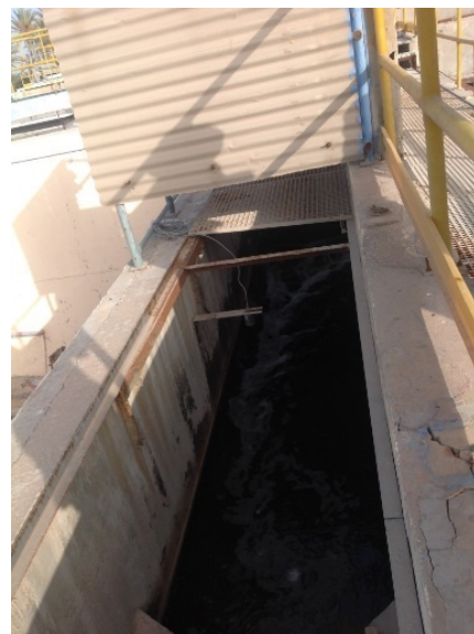
Canal de comptage boues recirculées
