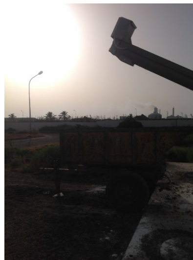
Alimentation benne à boues déshydratées
