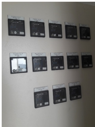
Façade armoire électrique
