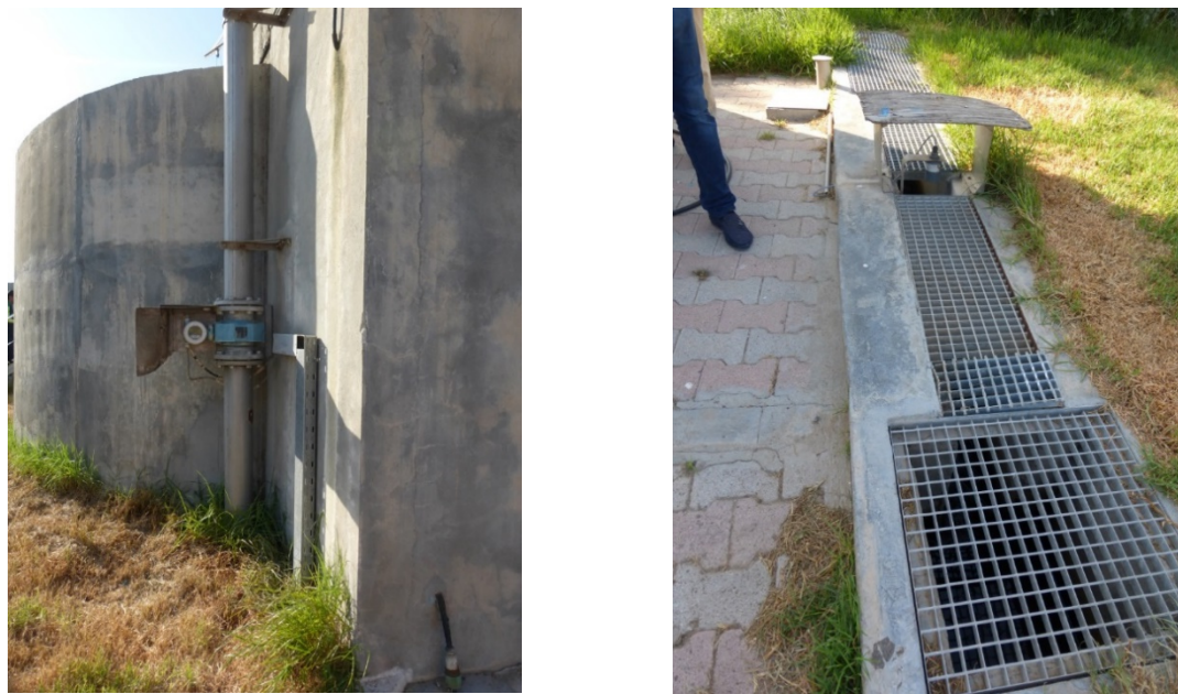
Figure 21 : Débitmètre électromagnétique en entrée station et Parshall en sortie station
