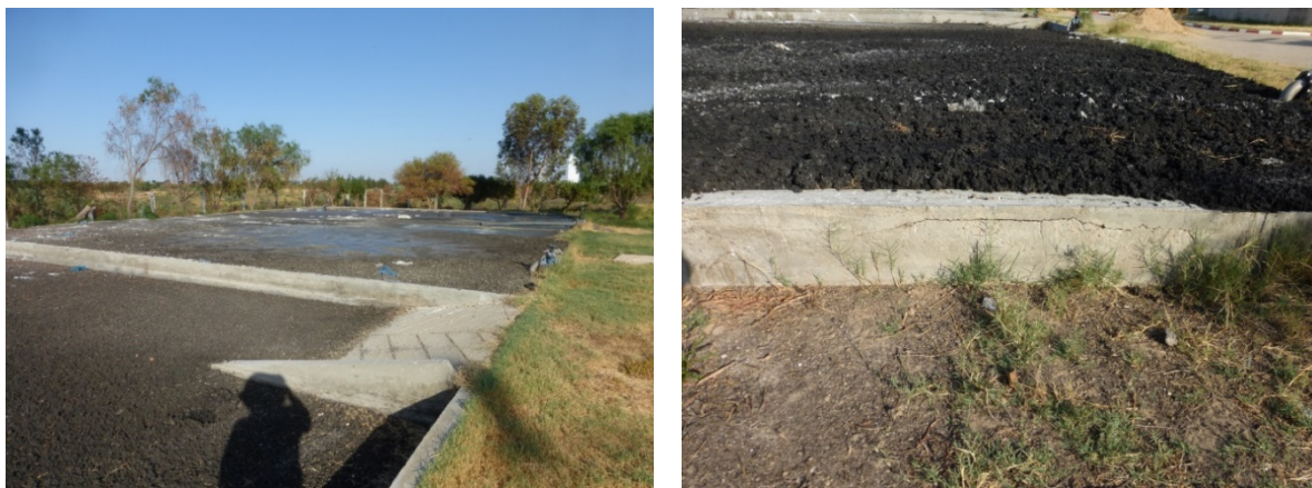
Figure 19 : Vue des lits de séchage (lits colmatés au fond) et des parois du lit
