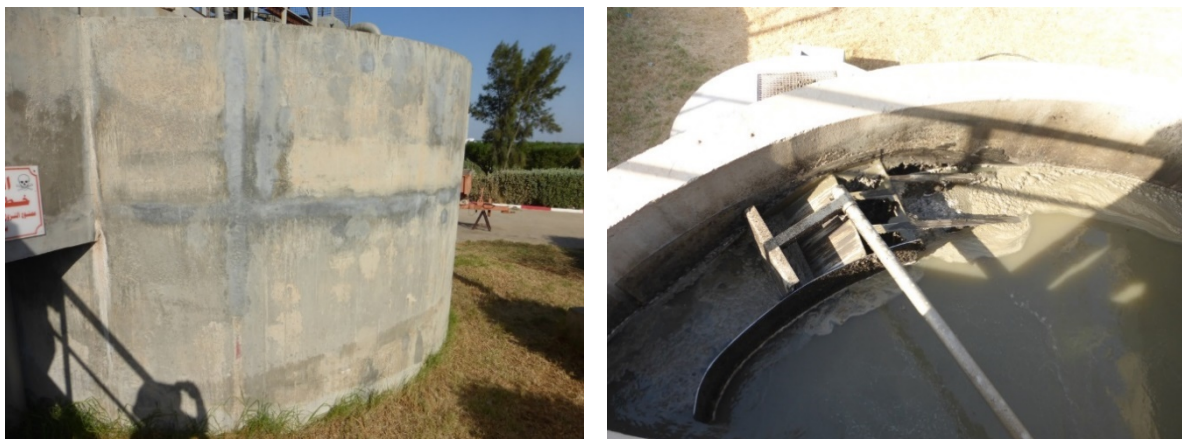
Figure 11 : Vue du dessableur / dégraisseur
