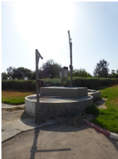
Figure 9 : Poste de relevage
