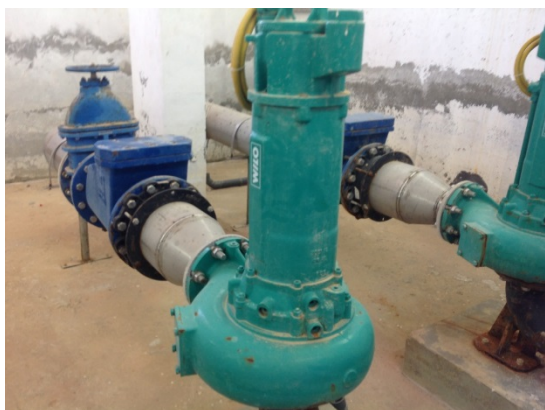
Pompes de recirculation
