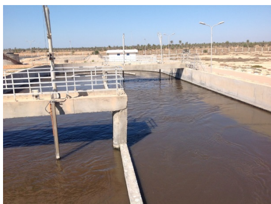
Vue partielle du bassin avec les agitateurs
