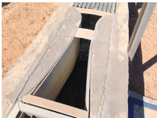
Canal venturi comptage eaux prétraitées
