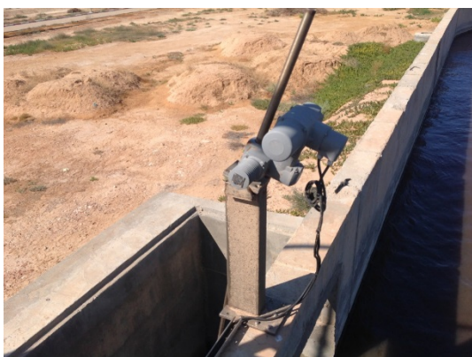
Electrovanne réglage seuil du bassin d'aération
