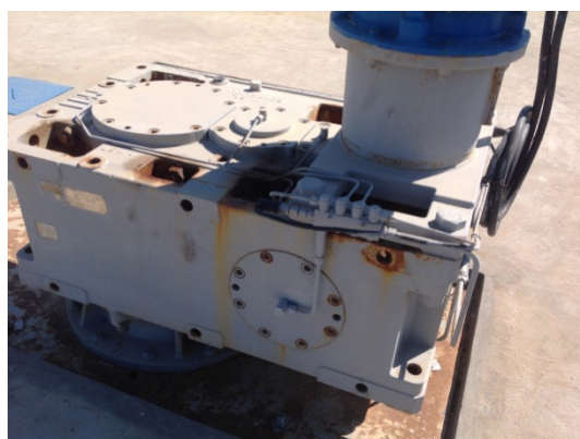
Motoréducteur de la turbine
