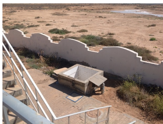
Désodorisation bache de dégazage
