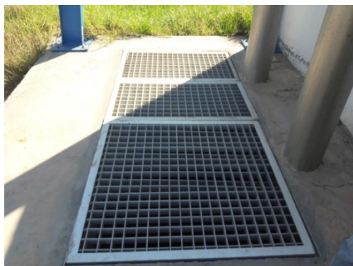
Bâche poste rejet eaux traitées en mer
