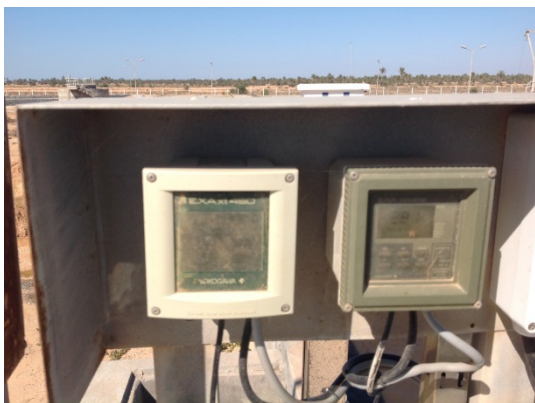
Transmetteurs sonde O 2 et Redox
