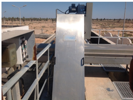
Vue partielle dégrilleur automatique
