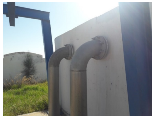
Vue partielle poste eaux traitées en mer
