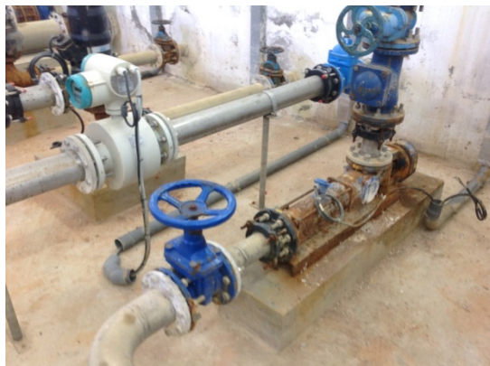
Débitmètre pompes à boues en excès
