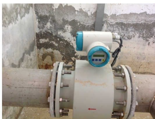
Débitmètre pompes recirculation
