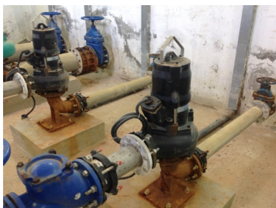
Pompes à boues en excès
