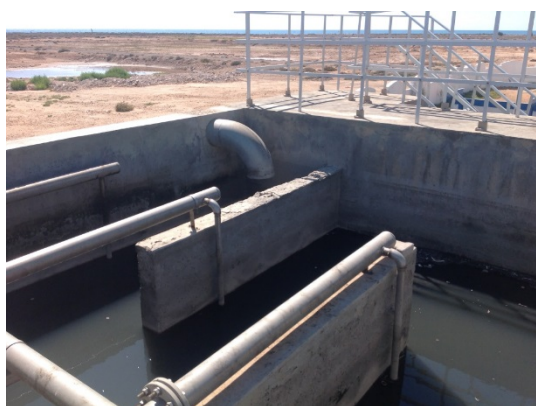
Vue partielle de la bache de dégazage
