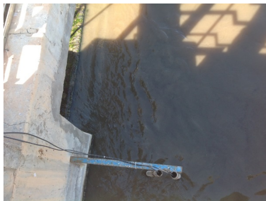
Sondes O 2 et Redox sortie bassin aération
