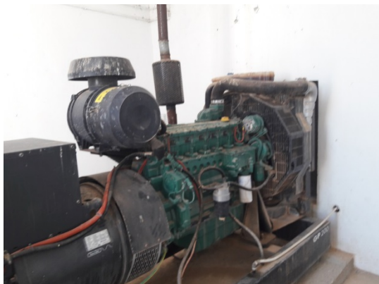
Vue partielle du groupe électrogène
